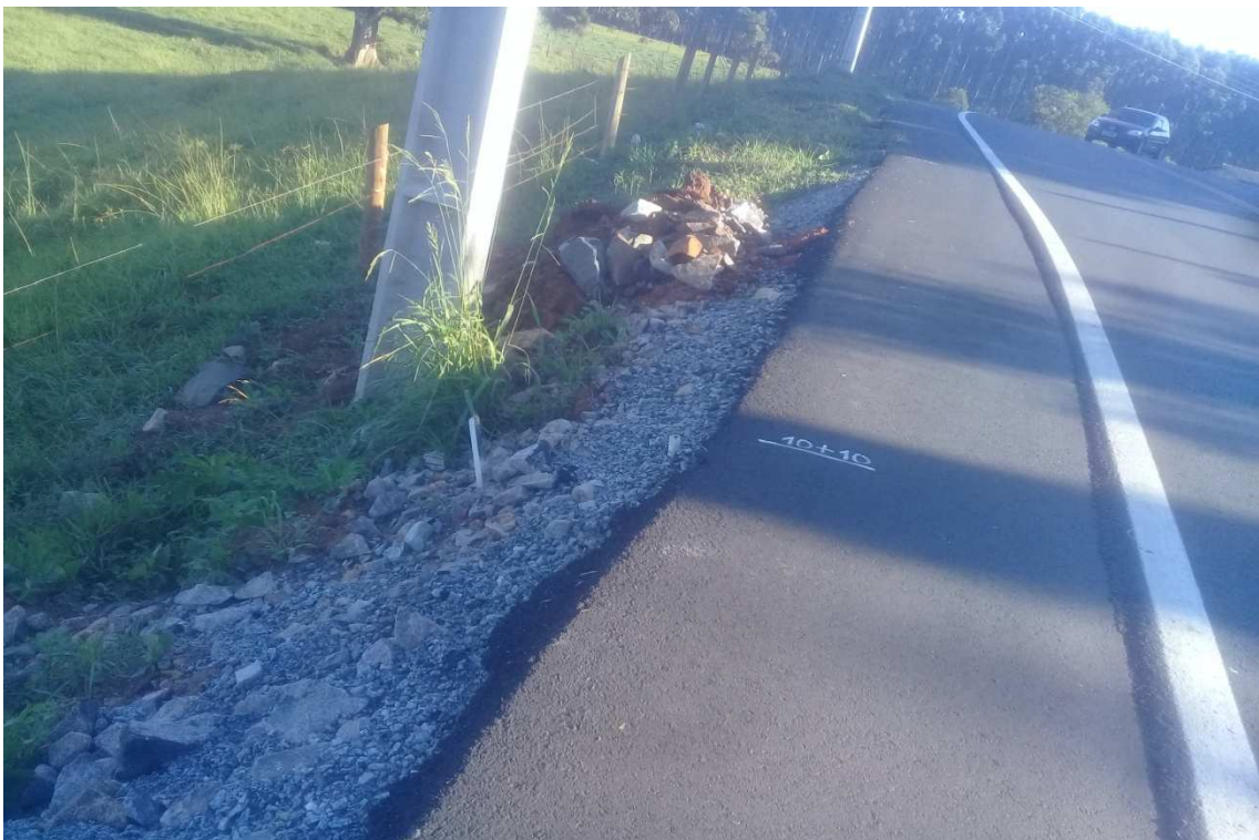
Imagem 02 - Desnível encontrado entre o terreno e o greide da rodovia (31/01/2019)
