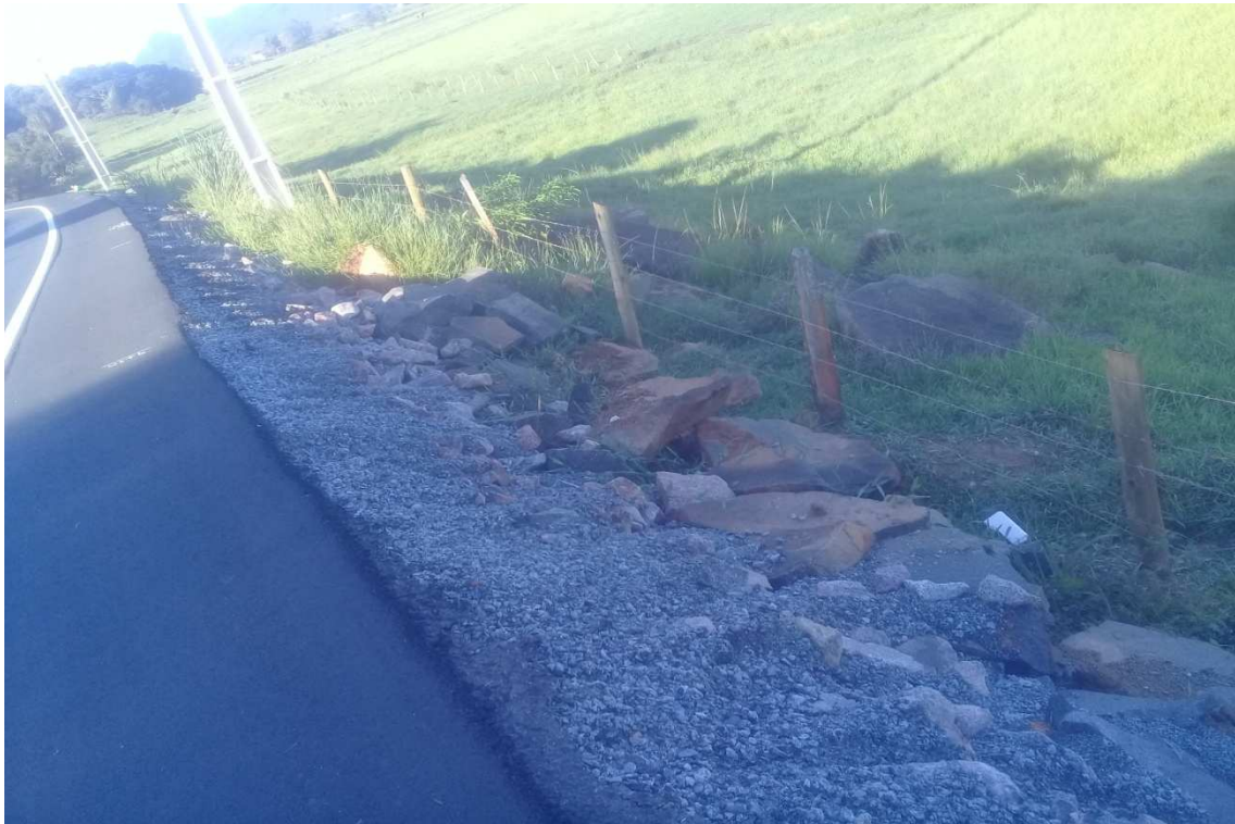
Imagem 01 - Desnível encontrado entre o terreno e o greide da rodovia (31/01/2018)
