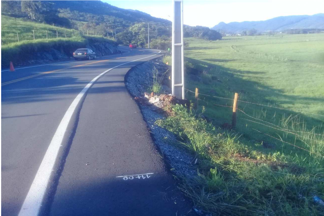
Imagem 05 - Desnível encontrado entre o terreno e o greide da rodovia (31/01/2019)
