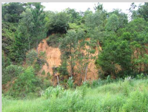
Figura 66: EROSÃO EM MARGEM DE RIO (PONTO 01)
